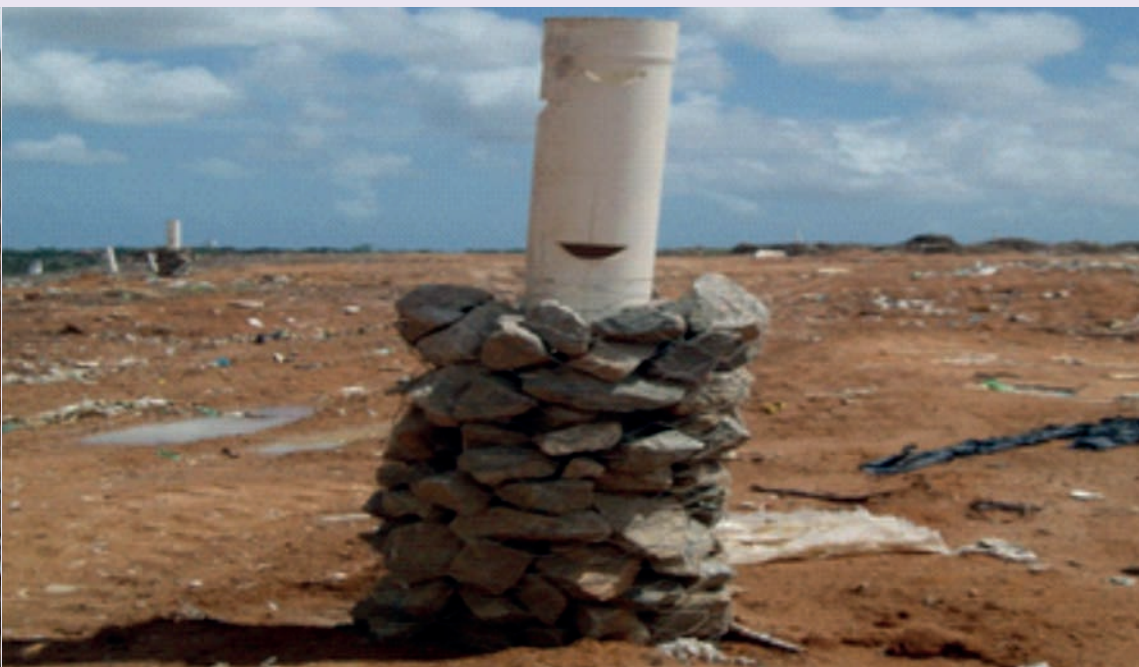
Aspecto de extravasores de gases (ver também ao fundo, à esquerda), que são tubos perfurados distribuídos ao longo das células de resíduos sólidos. Os gases coletados são emitidos para a atmosfera.
