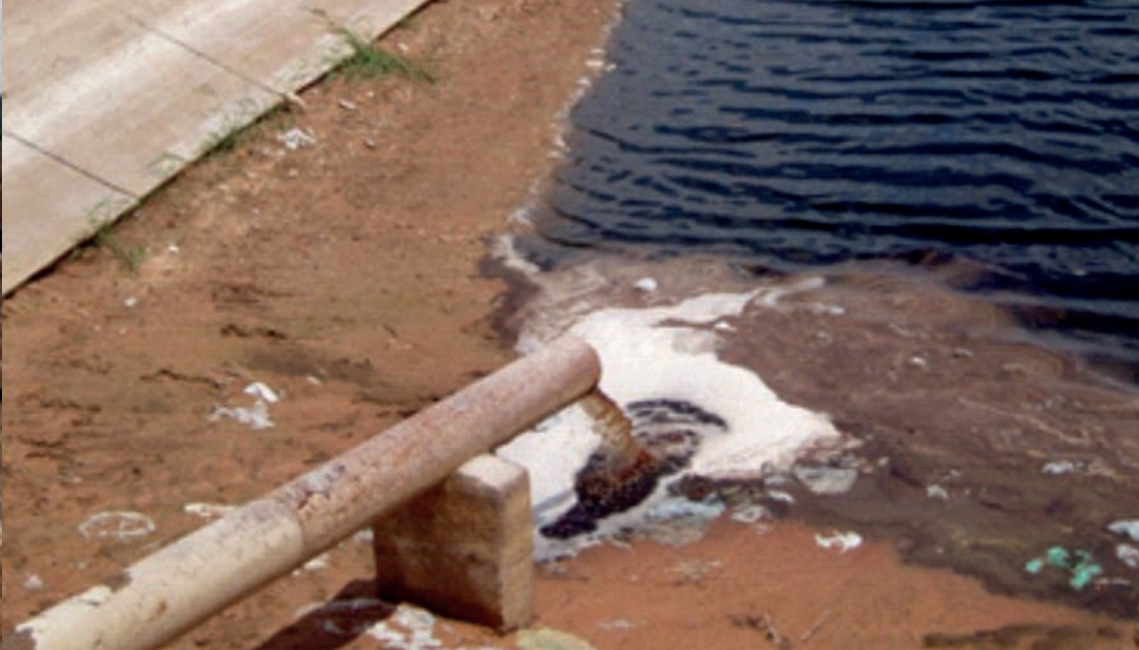
Tubulação, que provém do sistema de dreno de chorume, para proceder sua coleta, direcionamento e despejo em lagoas de estabilização.
